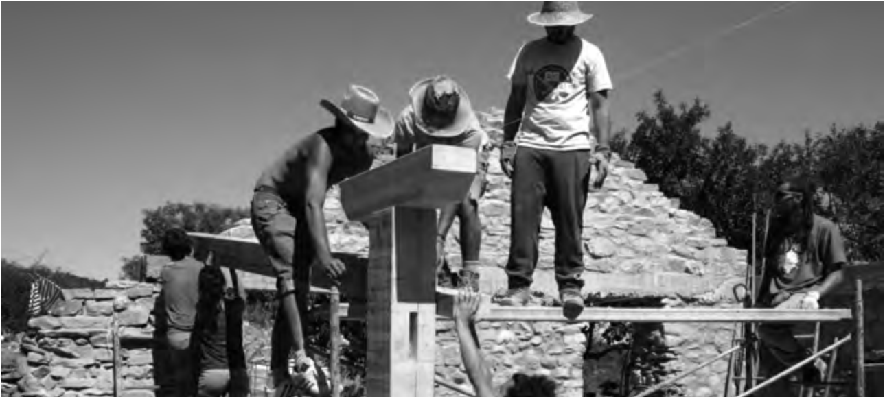
■ Trabajos de restauración en una de las casas del pueblo de Fraguas
